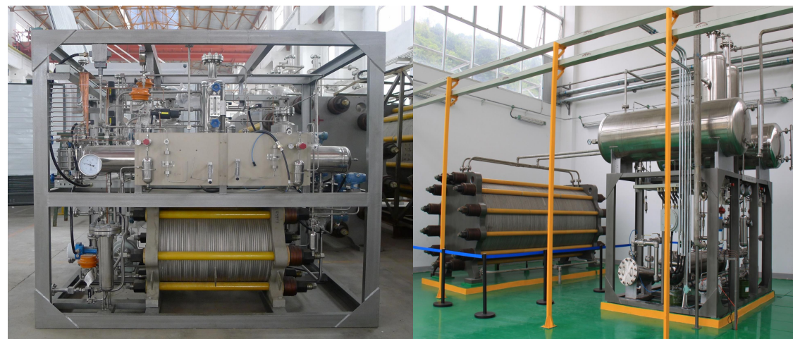
北京オリンピック水素製造設備 (水電解式)
