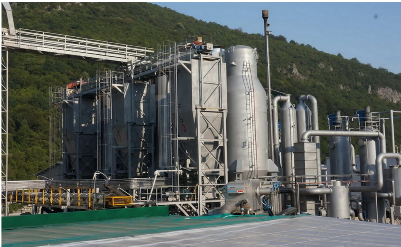
2MW バイオマスガス化発電所
