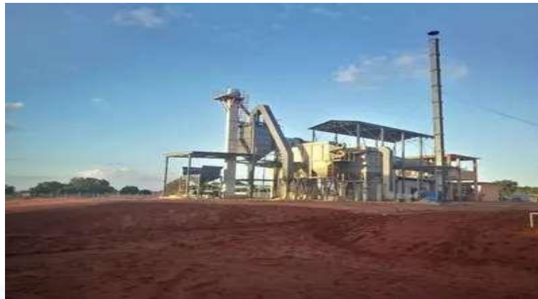
木質ペレット生産ライン
