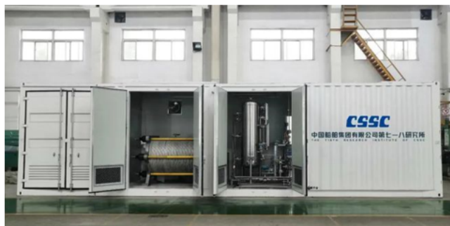
コンテナ式水素製造設備
