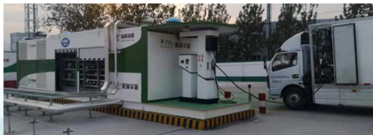
北京オリンピック水素充填ステーション
