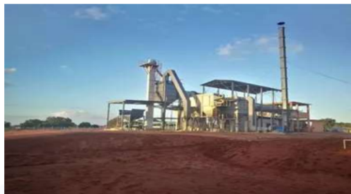
木質ペレット生産ライン
